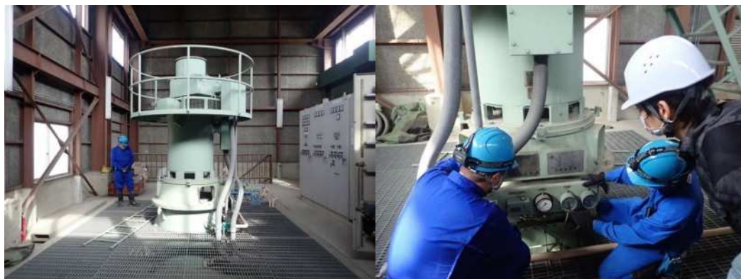
大下津排水機場（伏見区）のポンプ設備（左）と点検作業の様子（右）
